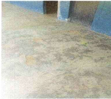
Foto 3: PISO EN MAL ESTADO
