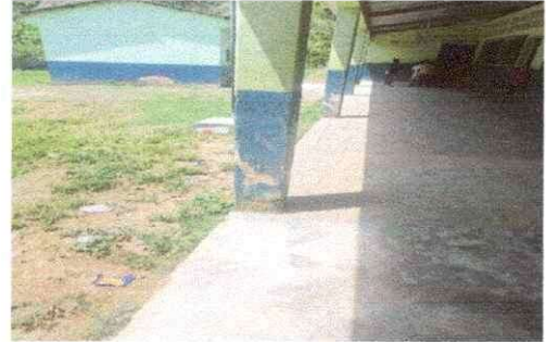
Foto 2: BASES U HORCONES EN MAL ESTADO
