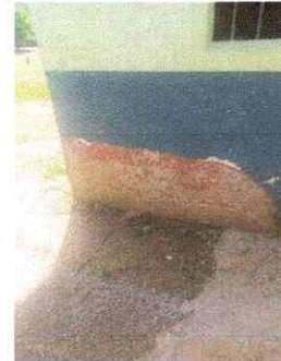
Foto 6: REPELLO EN MAL ESTADO
